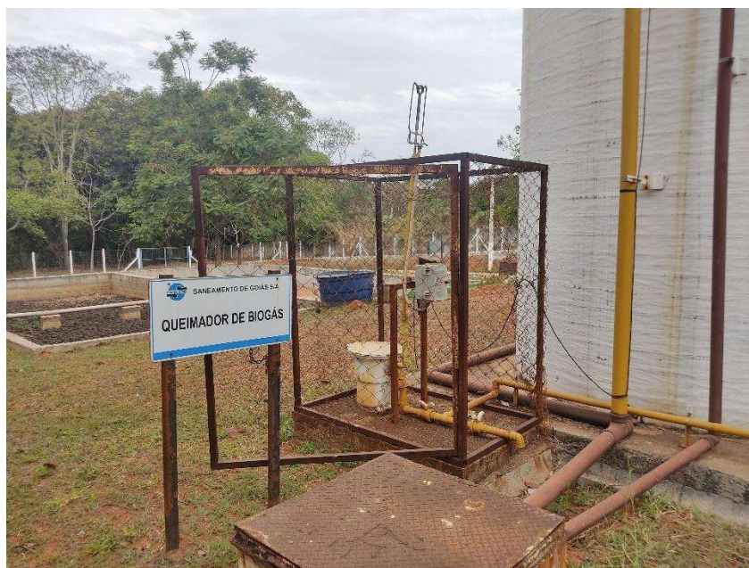
Figura 77 - Queimador de biogás
