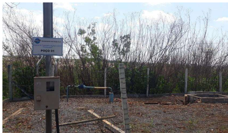
Figura 59 - Poço 01 – Jardim Flamboyant
