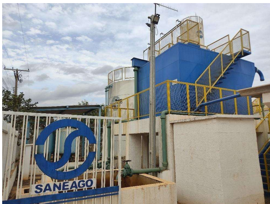
Figura 54 - ETA Compacta Jardim Flamboyant
