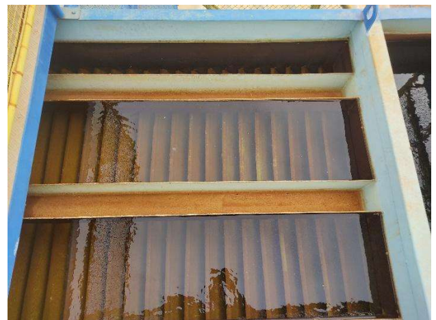
Figura 56 - Decantação ETA Flamboyant
