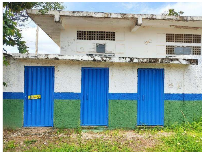
Figura 96 - Acondicionamento de RSS em UBSF Parque Alvorada
