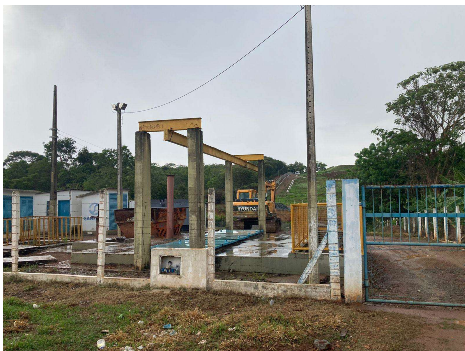
Figura 73 - Estação Elevatória de Esgoto
