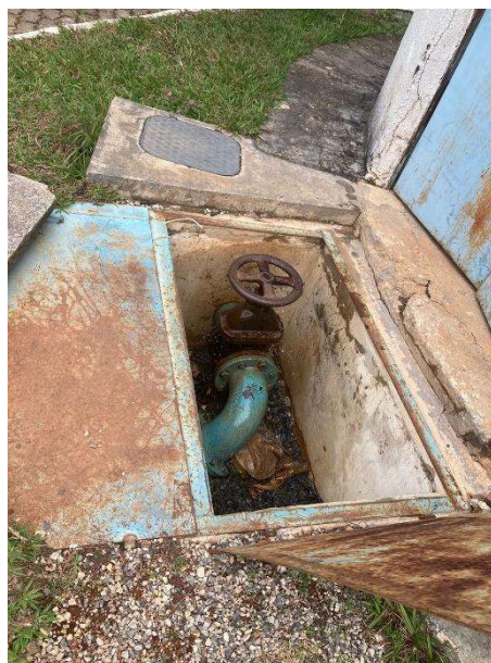
Figura 63 - Vazamento ETA Natal de Lima
