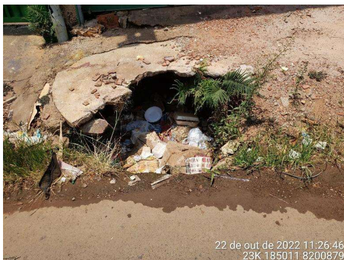
Figura 114 - Obstrução de boca de lobo com lixo
