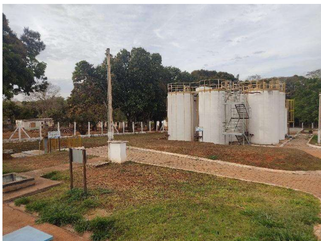
Figura 75 - Reatores ETE Raquel Pimentel
