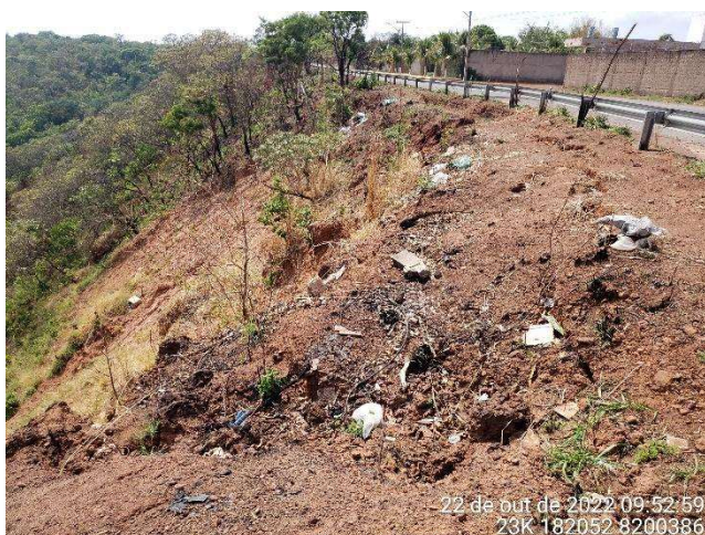
Figura 130 - Deslizamento de terra às margens da GO-425
