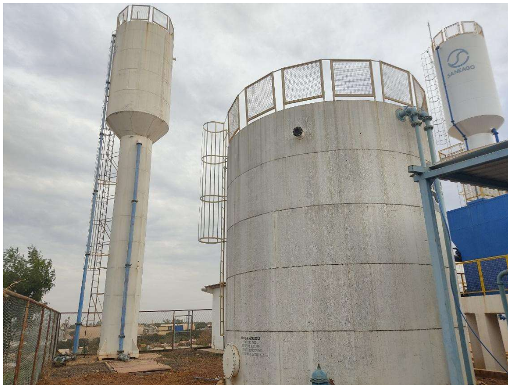
Figura 57 - Reservatórios ETA Flamboyant
