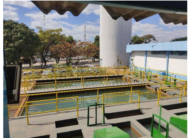
Figura 49 - Processo de floculação e decantação ETA Natal de Lima
