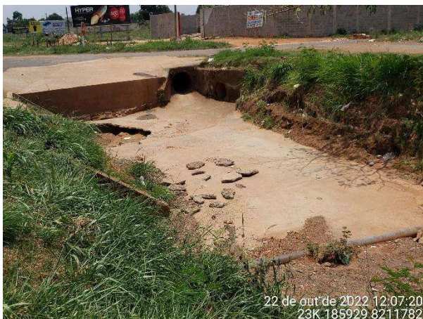
Figura 128 - Galerias com contenção em concreto danificada pelo volume de água
