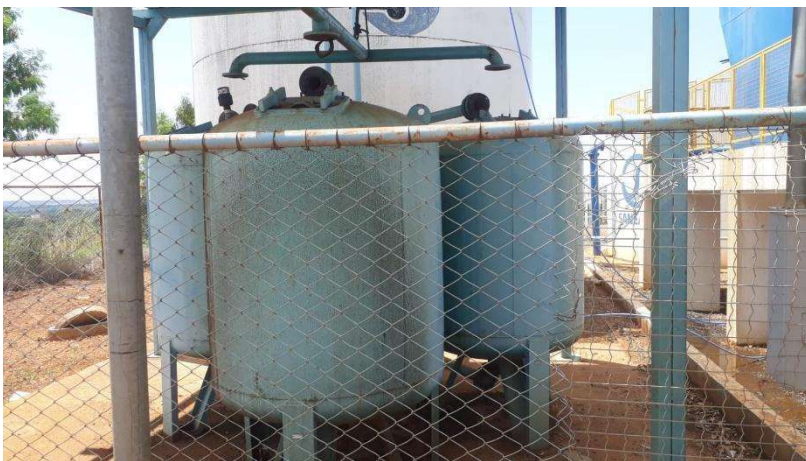
Figura 55 - Filtros desativados da ETA Flamboyant
