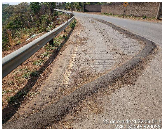
Figura 131 - Interdição parcial da pista
