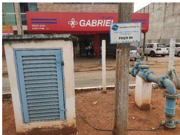
Figura 58 - Poço 04 – Jardim Ingá
