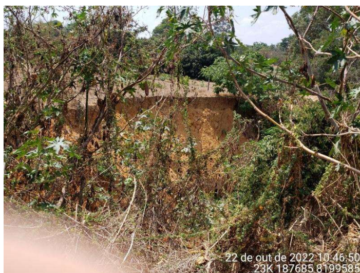
Figura 116 - Processo erosivo ativo
