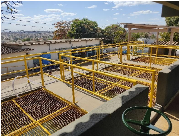
Figura 50 - Filtração e cloração complementar da ETA Natal de Lima
