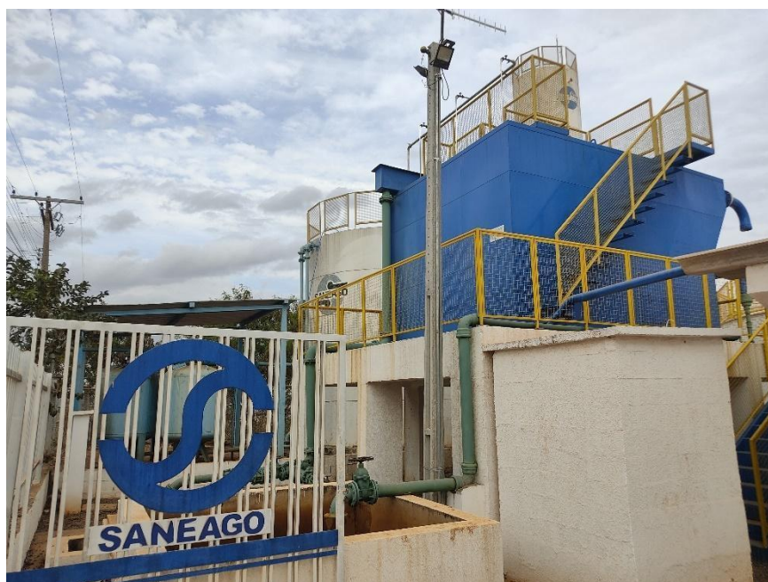
Figura 54 - ETA Compacta Jardim Flamboyant
