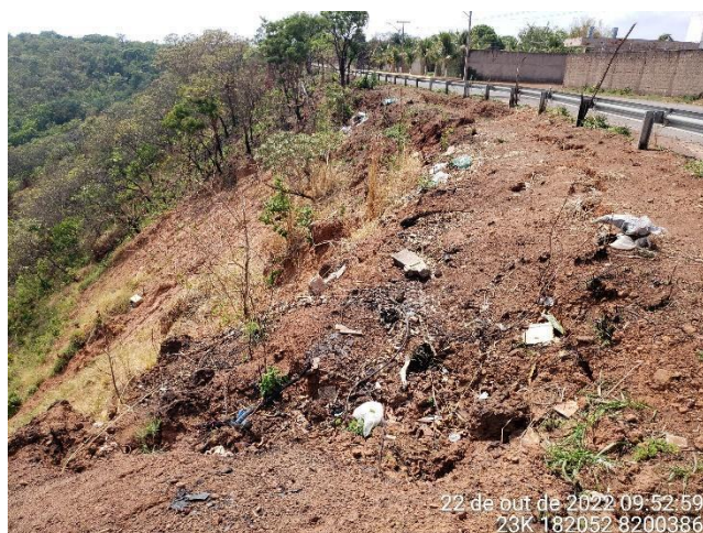
Figura 130 - Deslizamento de terra às margens da GO-425
