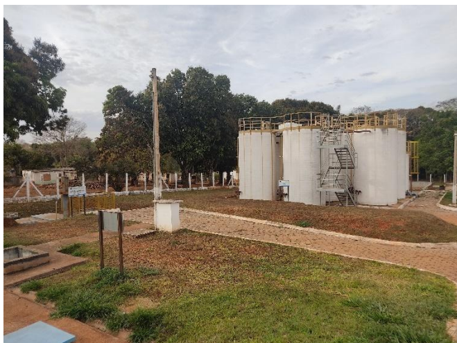
Figura 75 - Reatores ETE Raquel Pimentel
