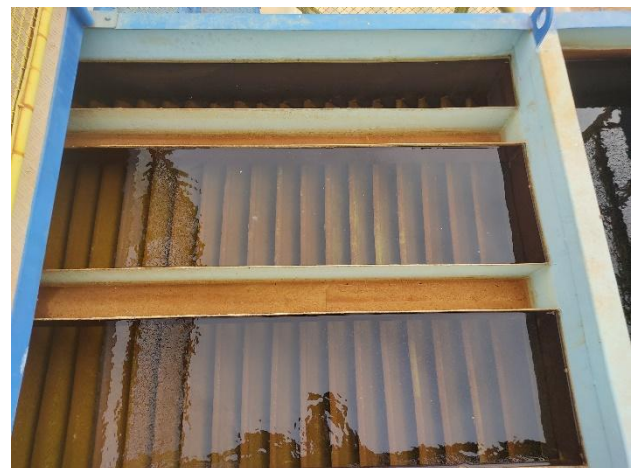
Figura 56 - Decantação ETA Flamboyant
