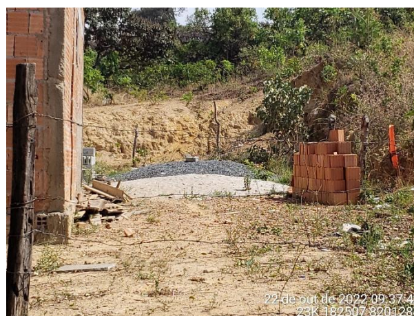
Figura 121 - Processo erosivo às margens de residências
