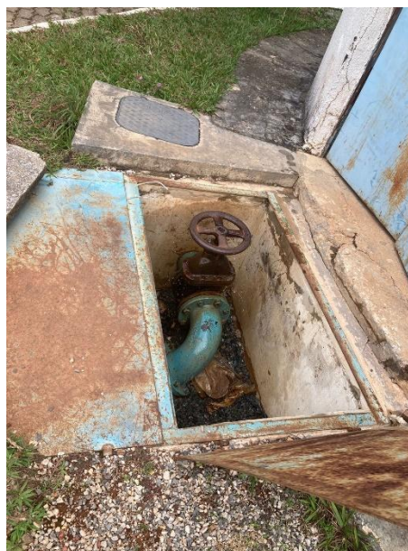
Figura 63 - Vazamento ETA Natal de Lima
