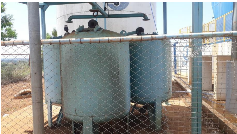
Figura 55 - Filtros desativados da ETA Flamboyant
