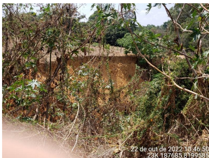
Figura 116 - Processo erosivo ativo
