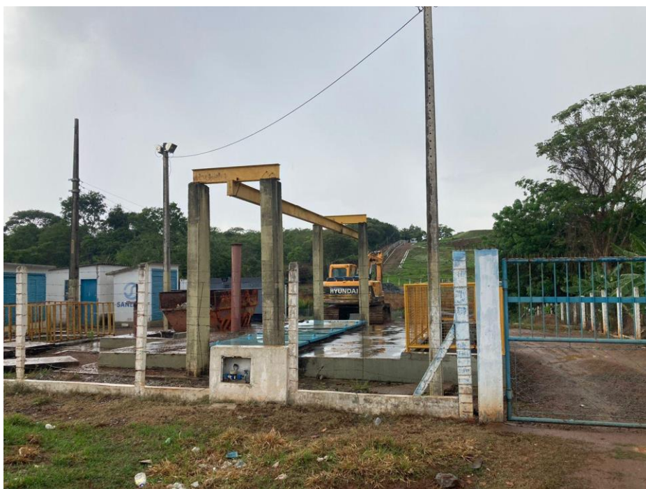
Figura 73 - Estação Elevatória de Esgoto
