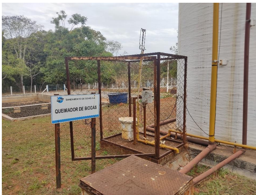
Figura 77 - Queimador de biogás
