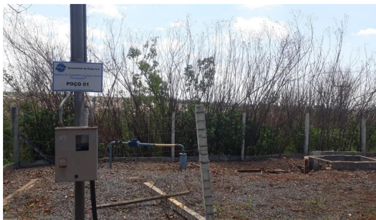
Figura 59 - Poço 01 – Jardim Flamboyant
