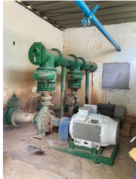
Figura 44 - Estação Elevatória de Água Bruta 2 (EEAB2 – Palmital) (vista 2)
