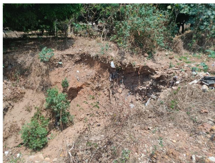
Figura 117 - Processo erosivo próximo a residências
