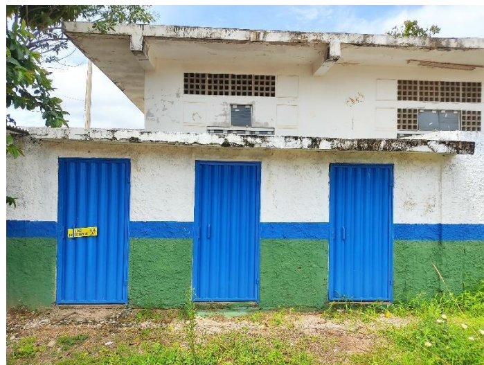
Figura 96 - Acondicionamento de RSS em UBSF Parque Alvorada
