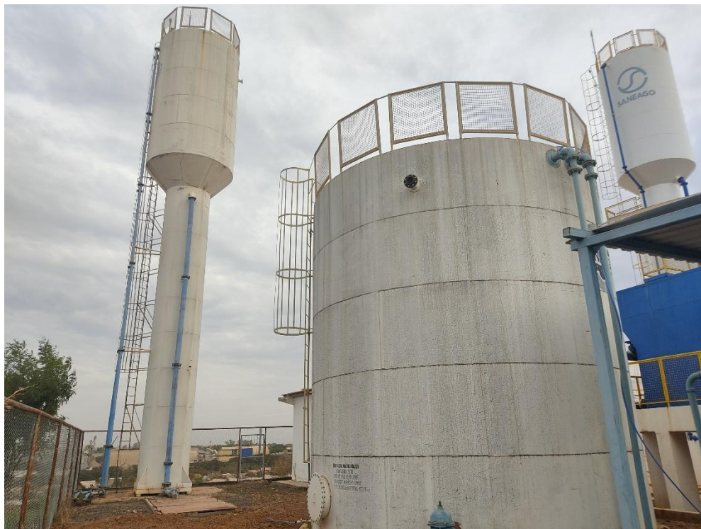
Figura 57 - Reservatórios ETA Flamboyant
