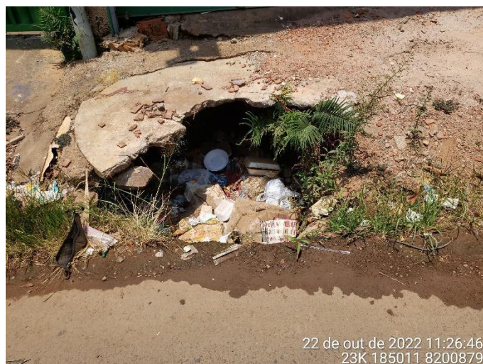
Figura 114 - Obstrução de boca de lobo com lixo
