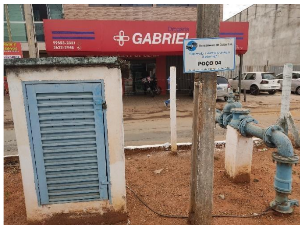
Figura 58 - Poço 04 – Jardim Ingá
