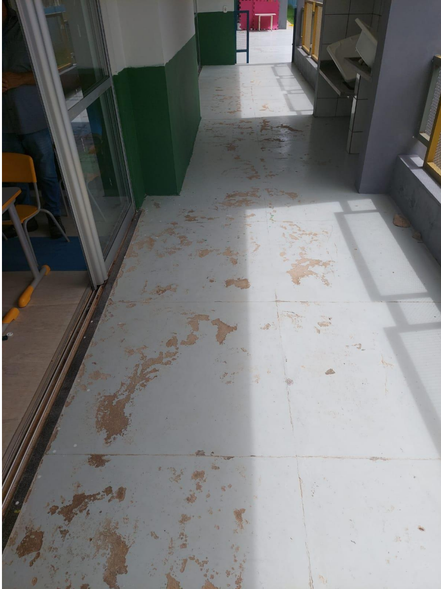
Piso com Pintura danificada
