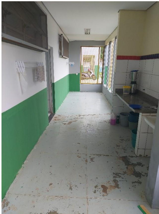
Imagem 01: Piso com falhas de pintura
