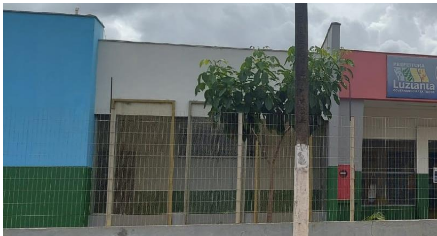
Imagem 02: Piso com falhas de pintura
