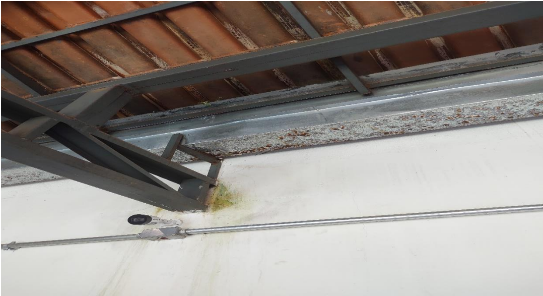
Fundo de calha enferrujada
