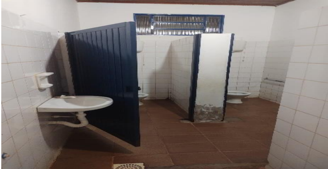
Exemplo de revestimento cerâmico a ser substituído
