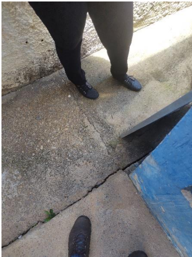
Rachadura calçada externa
