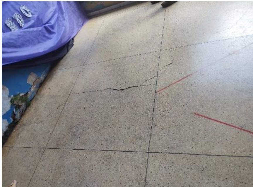
Rachadura piso do pátio
