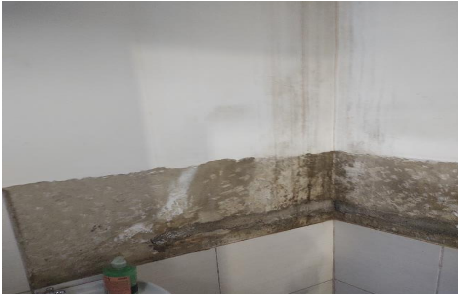
Local onde cerâmicas devem ser assentadas no W.C
