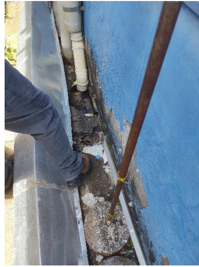
Rachadura calçada externa
