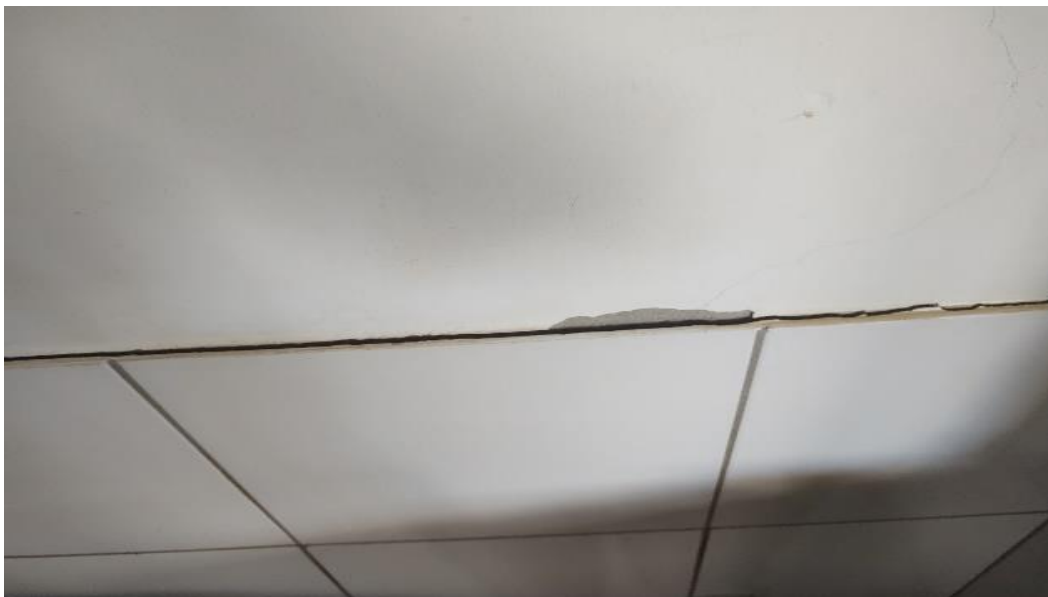
Exemplo de revestimento cerâmico a ser substituído
