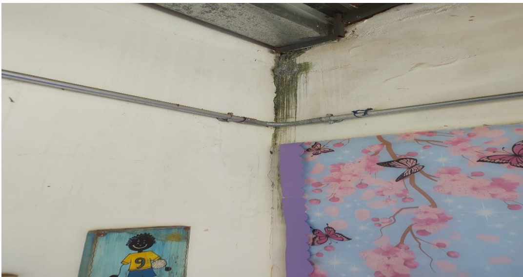
Vazamento na calha
