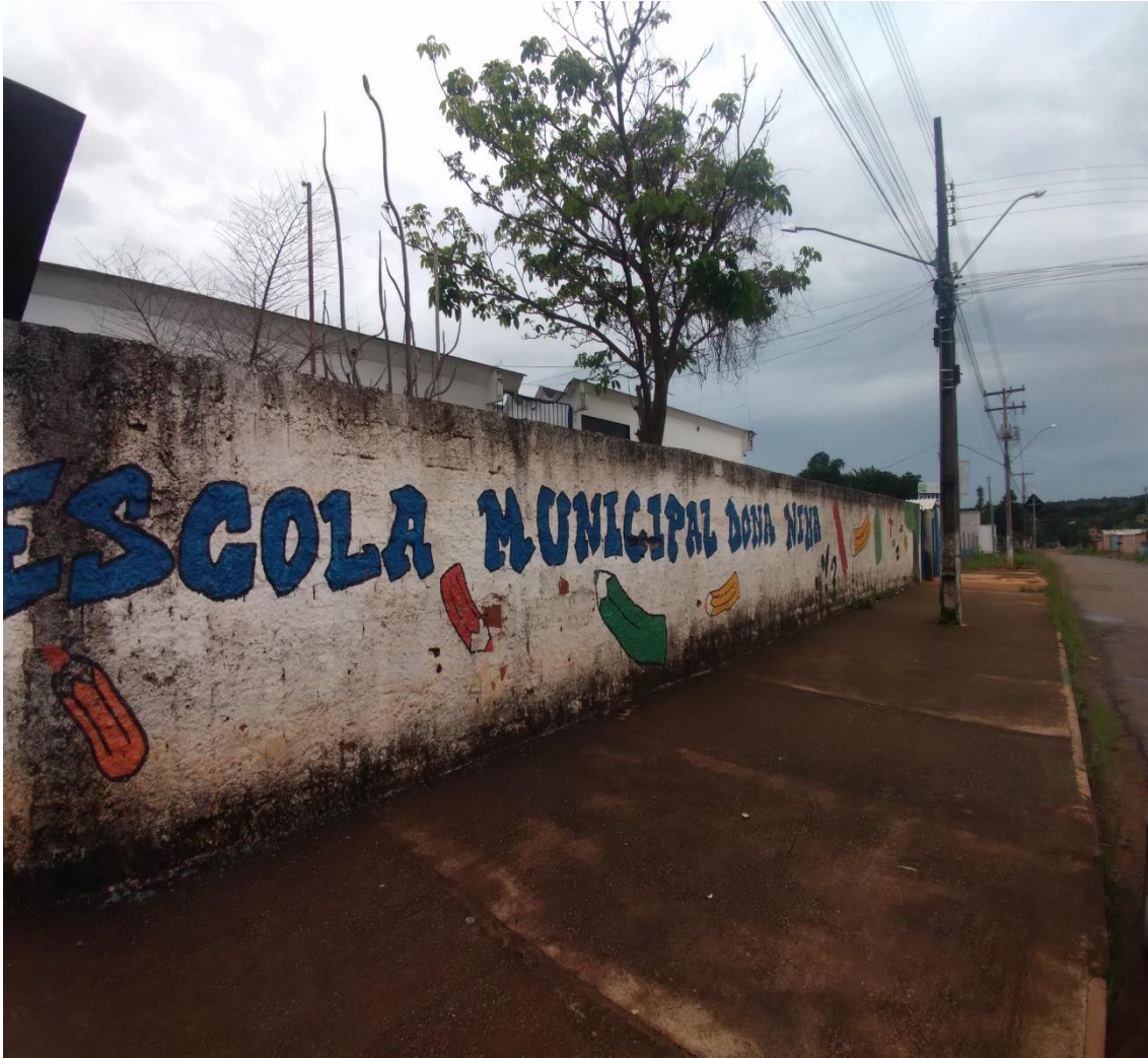
Muro da escola com pintura danificada e letreiro a ser refeito.
