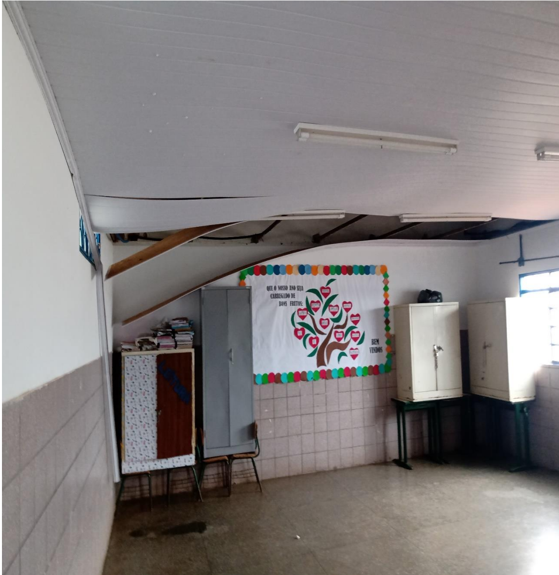
Forro PVC danificado
