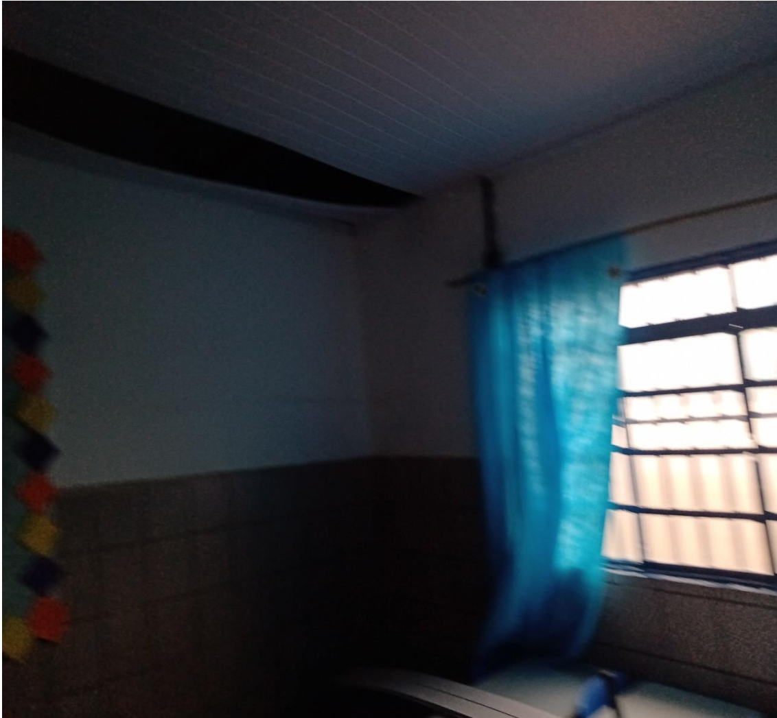
Forro PVC danificado
