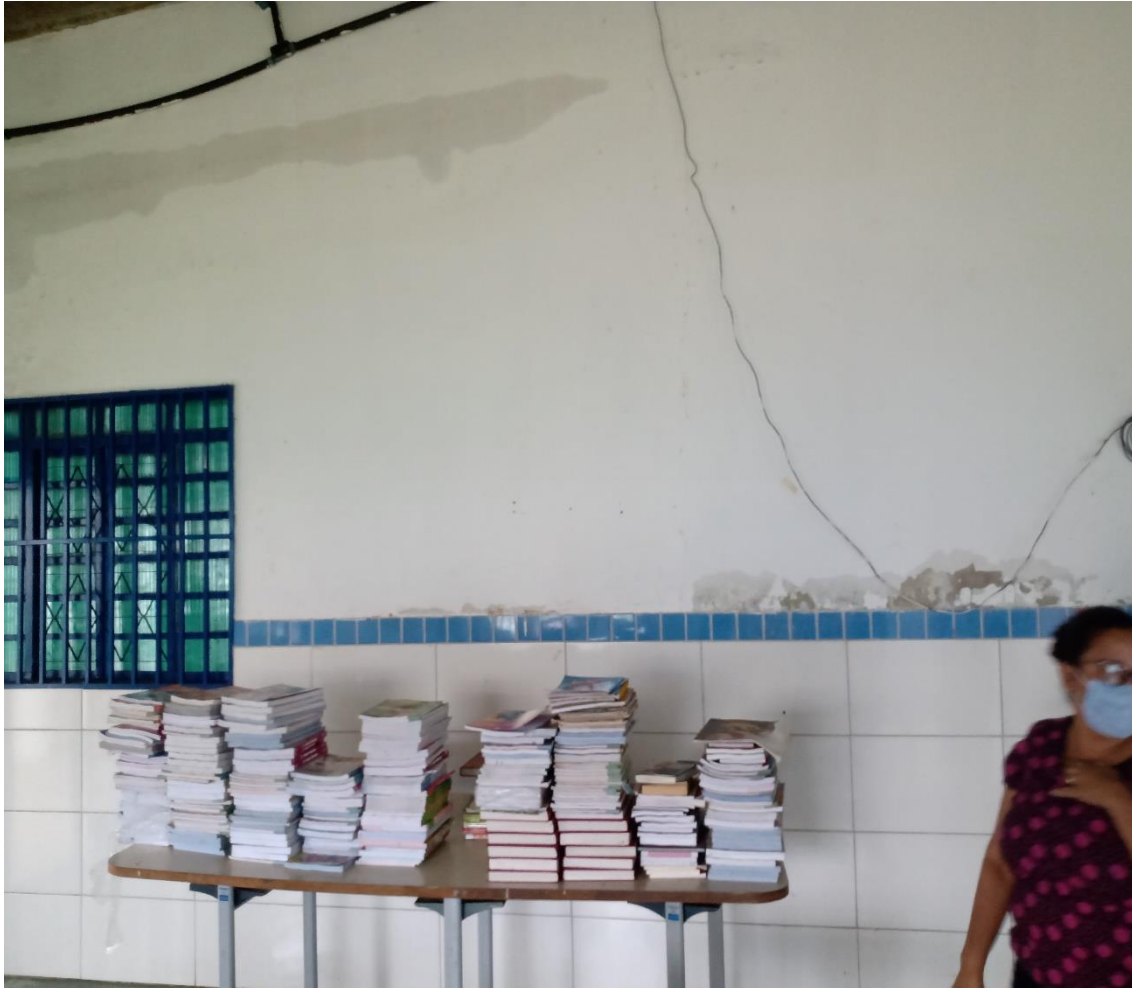
Pintura Interna Danificada.
