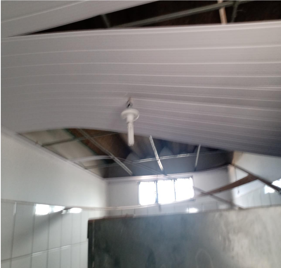
Forro PVC danificado
