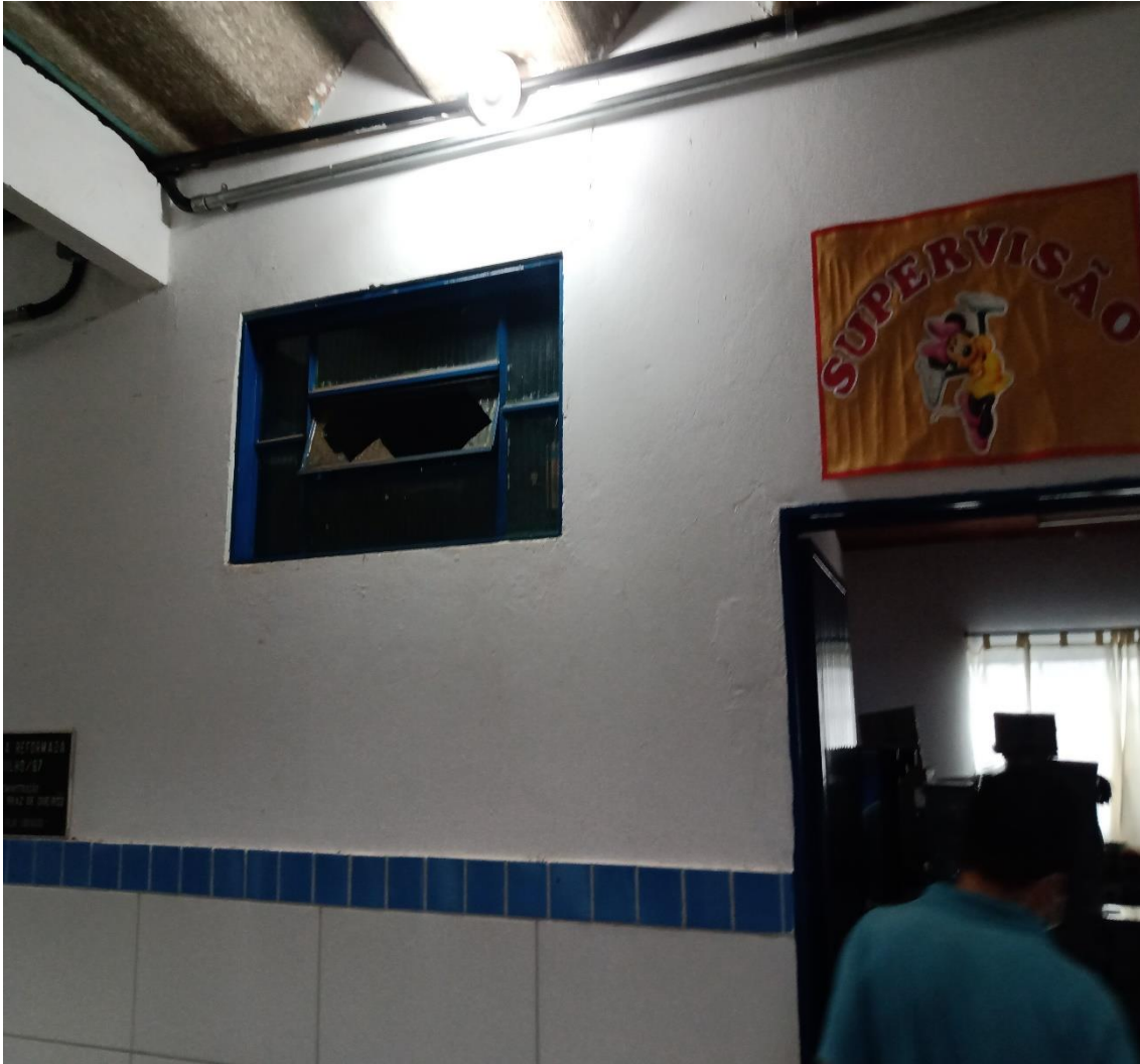
Esquadria com vidro quebrado
