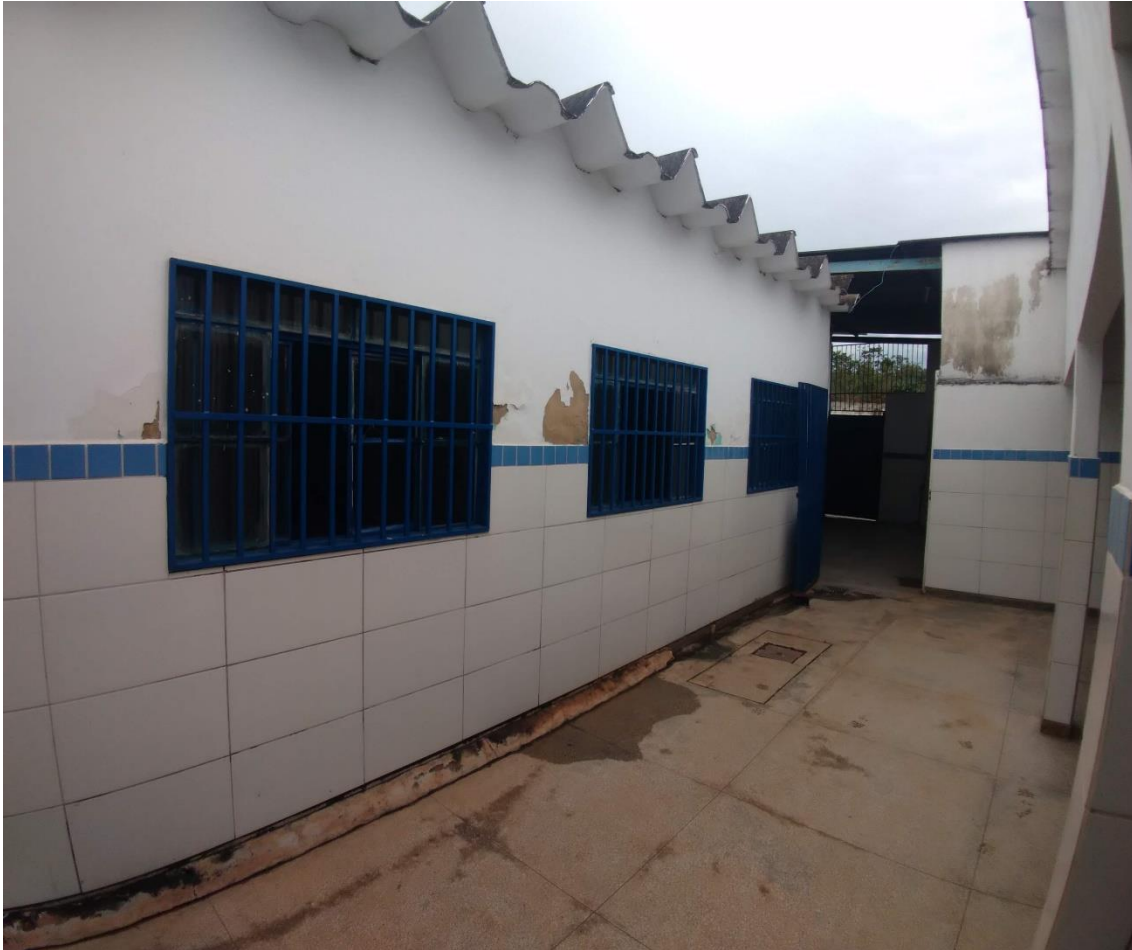
Pintura externa danificada
