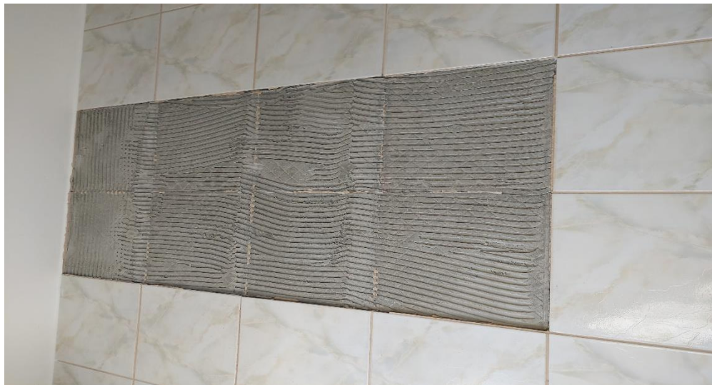
Sem parte do revestimento
