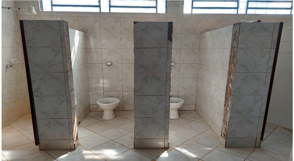
Box do banheiro sem porta e portal
