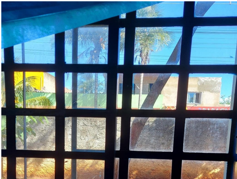
Exemplo de vidro quebrado.
