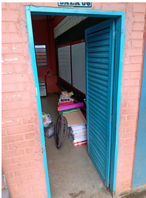
Imagem 05: Exemplo de porta a ser substituída.
