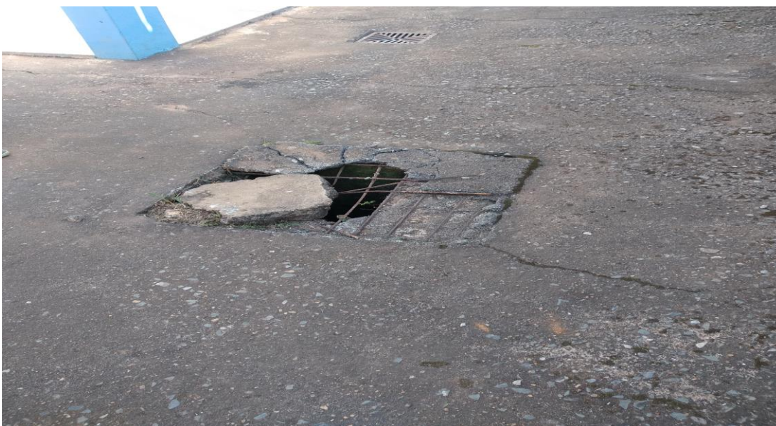
Caixa de passagem com Tampa quebrada
