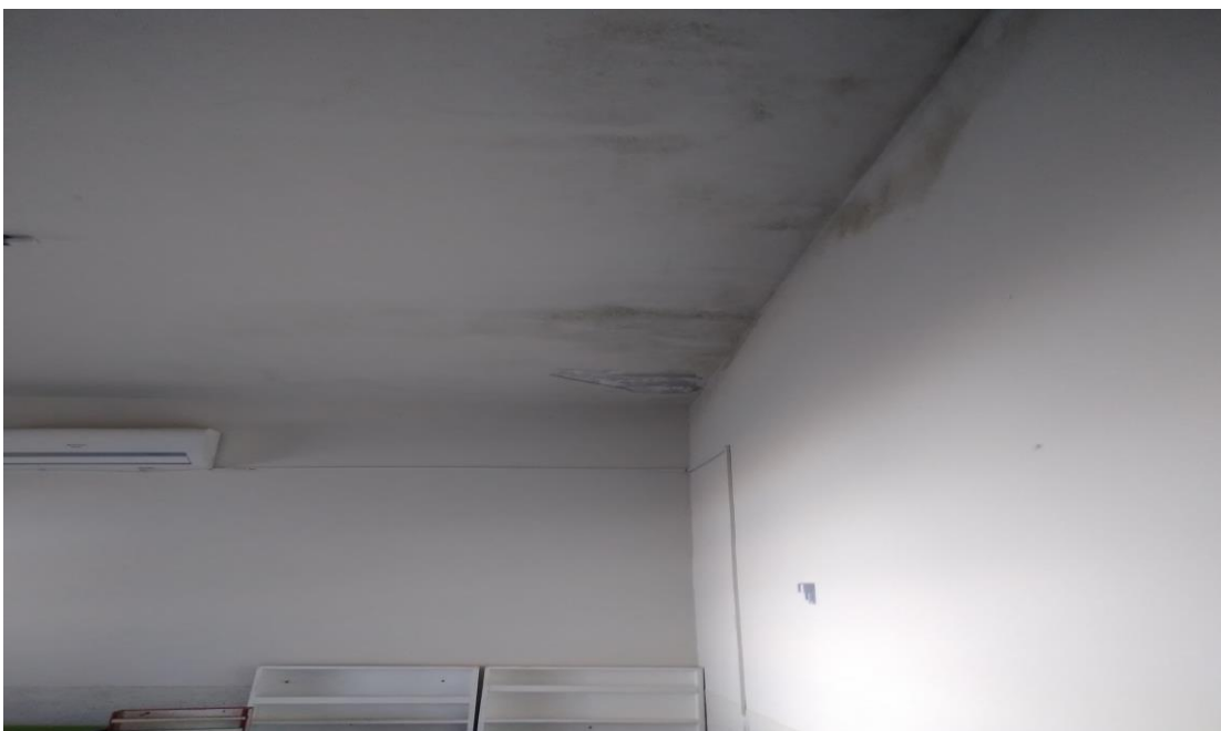
Sala com infiltração
