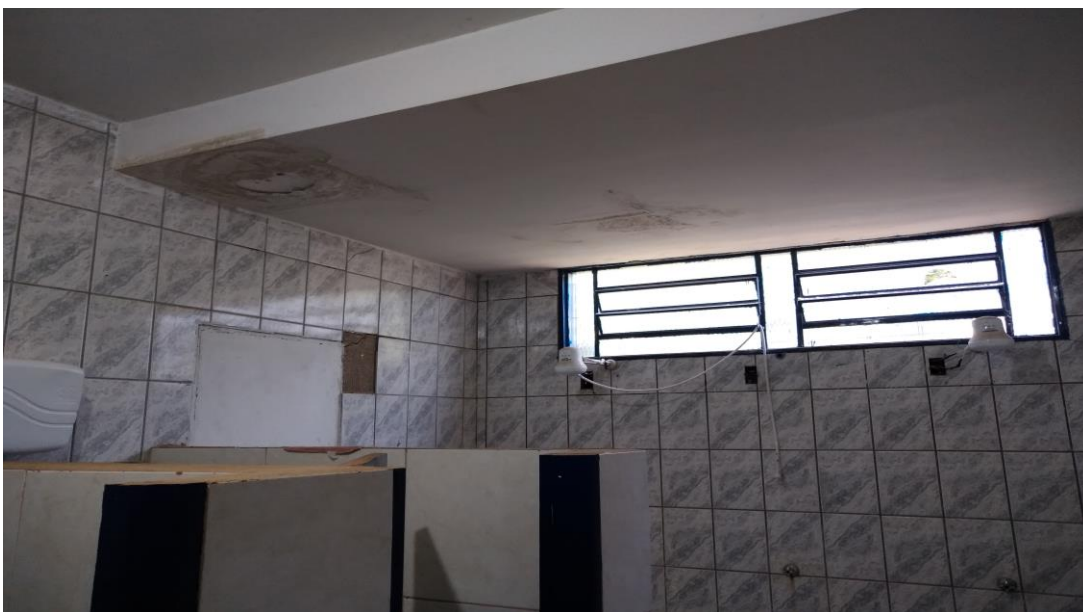
Infiltração, cerâmica quebrada
