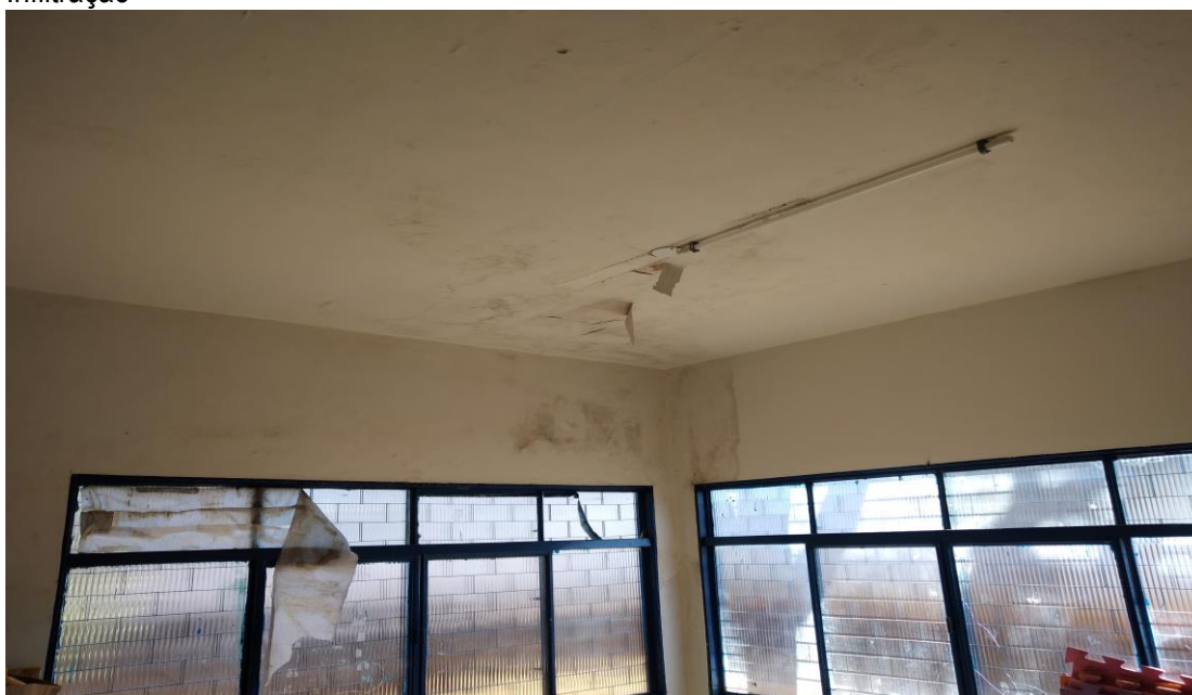
Teto com Infiltração
