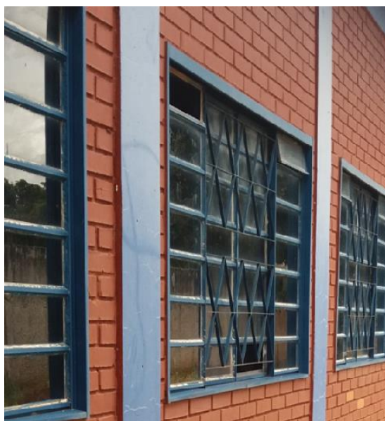
Imagem 02: Exemplo de vidro quebrado.
