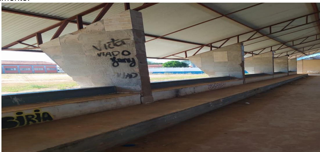
Pilares da quadra sem revestimento
