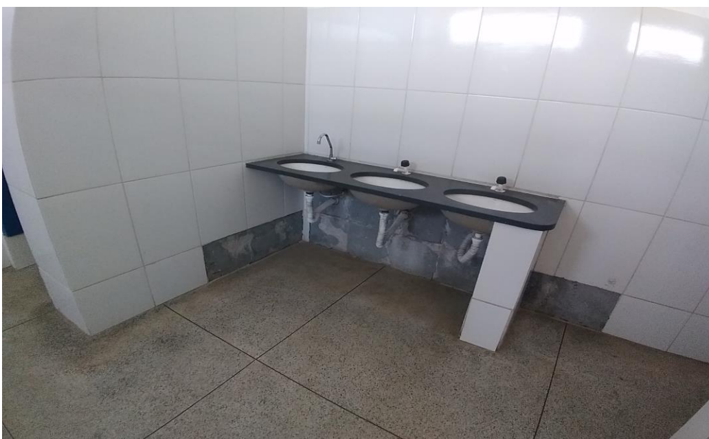
Cerâmicas caídas - banheiro
