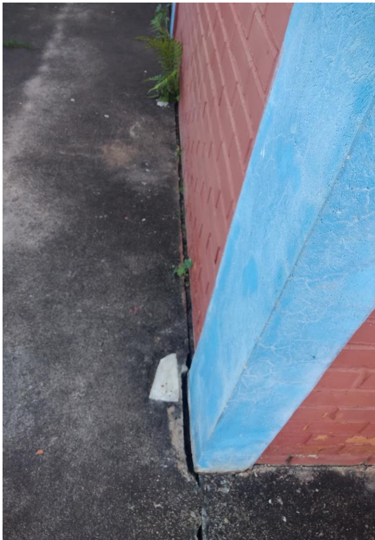
Abertura no piso externo, possibilitando entrada de água
