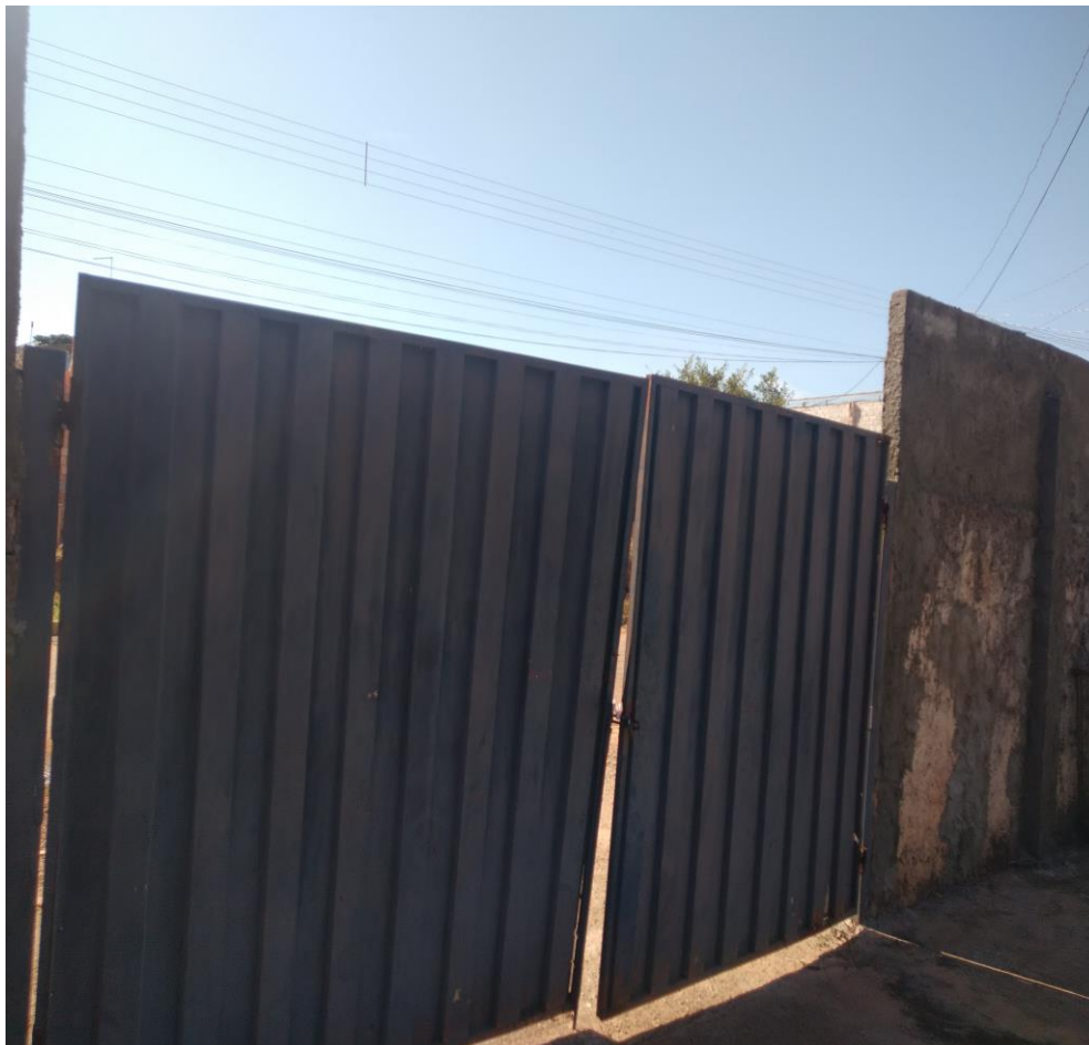
Portão a ser substituído
