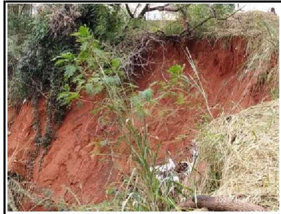
ASSOREAMENTO DE ENCOSTAS
