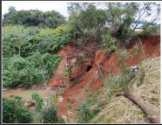
ASSOREAMENTO DE ENCOSTAS
