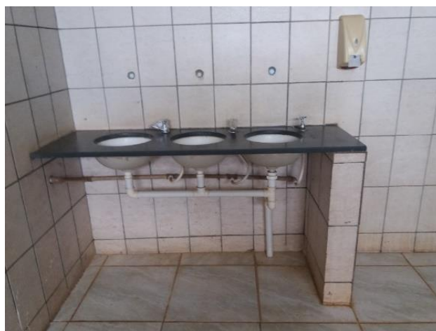
Imagem 11: Lavatório do banheiro feminino.
