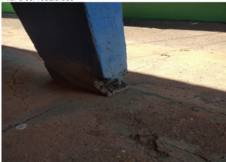
Pilar a ser restaurado
