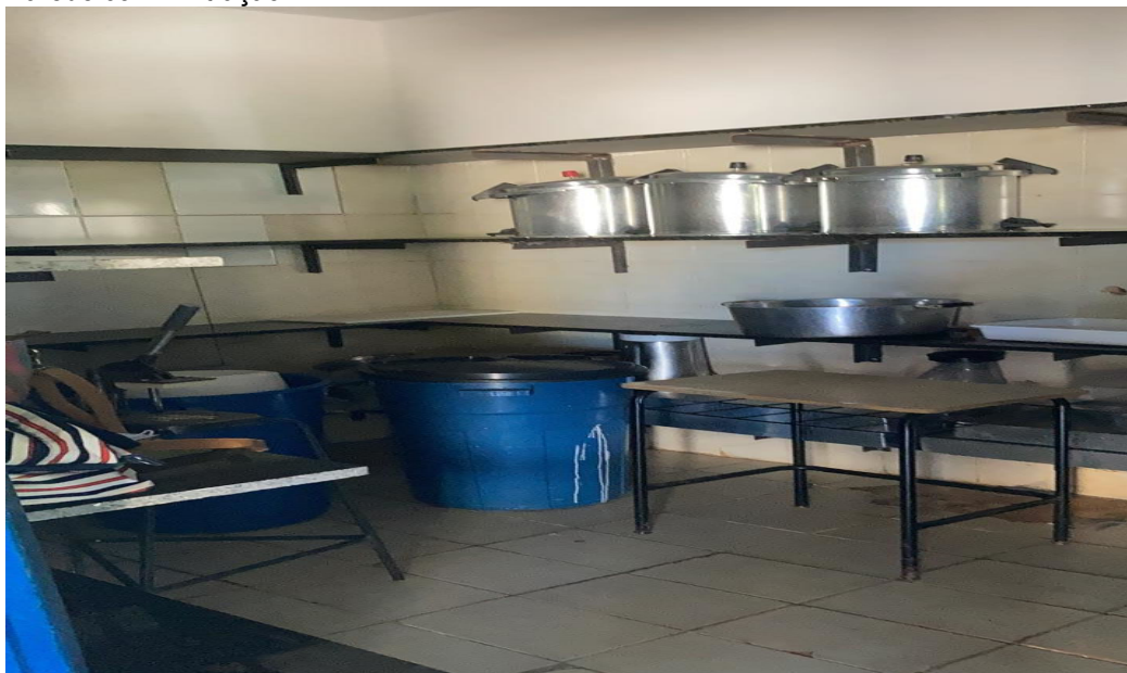
Cerâmica quebrada despensa
