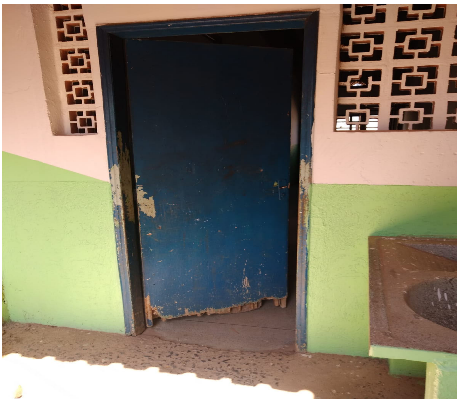
Porta danificada – substituir porta
