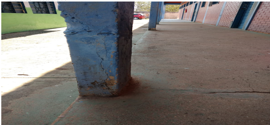
Pilar a ser restaurado
