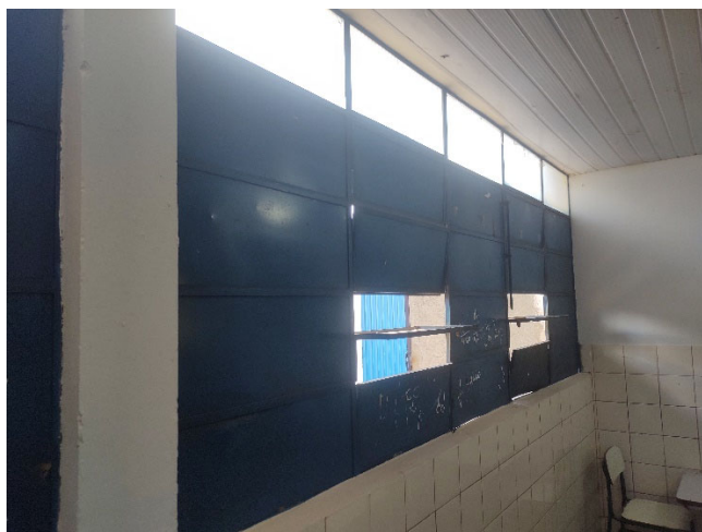
Imagem 03: Exemplo de janelas a serem substituídas.
