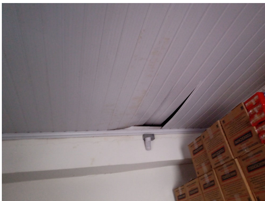
Imagem 05: Exemplo reparo a ser feito no forro.
